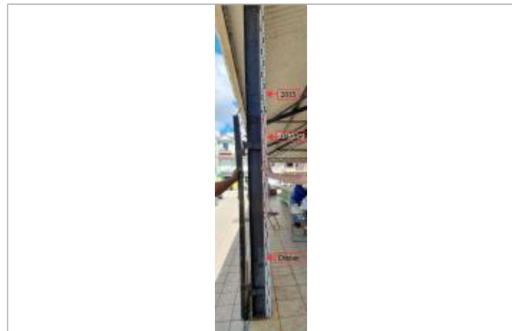
Hauteur des crues du 06/11/15; 27/08/19; 31/10/19
