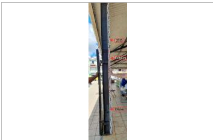
Hauteur des crues du 06/11/15; 27/08/19; 31/10/19
