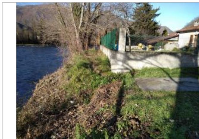
Laisse de crue au niveau de la dalle béton
