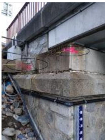
Laisse de crue 80cm au dessus de l'échelle hydrométrique de Vicdessos
