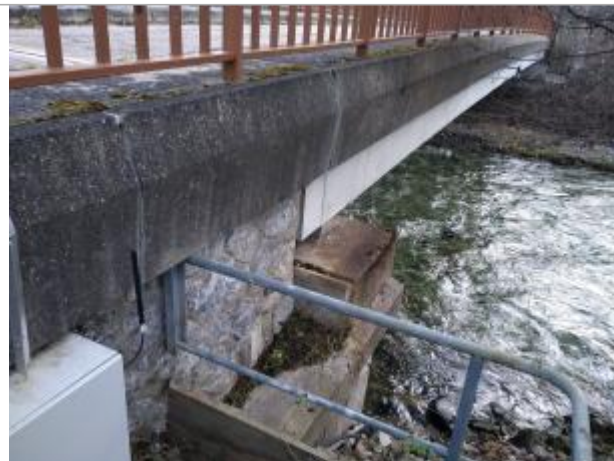
Pont et poste de télétransmission au 1er plan
