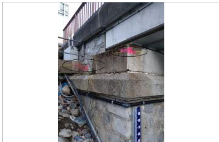
Laisse de crue 80cm au dessus de l'échelle hydrométrique de Vicdessos
