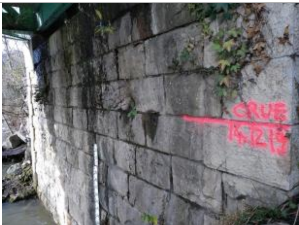
Hauteur atteinte le 14/12/2019 - environ 3m70 à l'échelle
