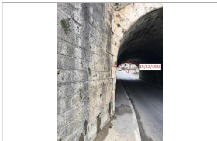
Marque de la crue de décembre 1981
