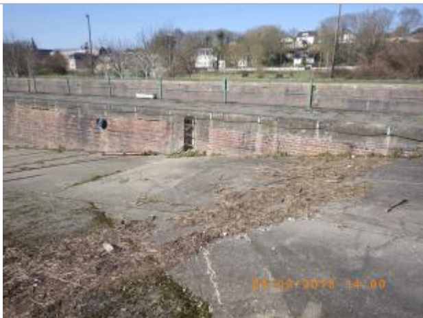
laisses d'inondation (brindilles) visibles (photo SPC SACN)
