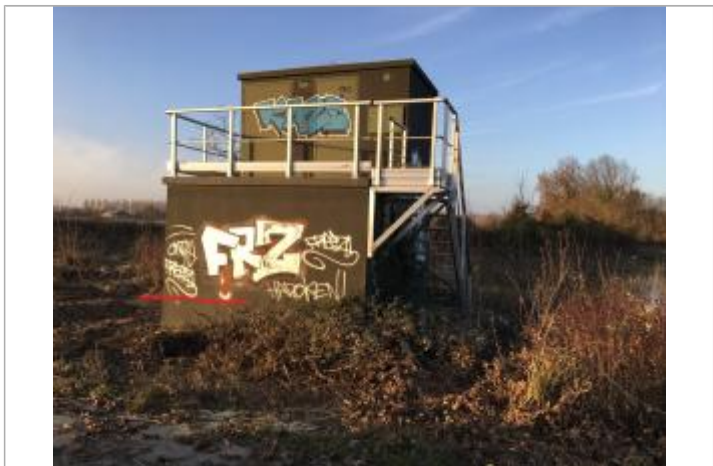
La crue est arrivée 2.00 m en dessous de la terrasse du transformateur
