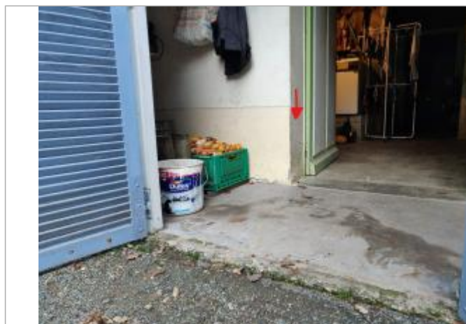
Vue de l'ancienne laisse au niveau de la flèche rouge sur mur façade ouest de la maison
