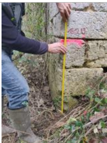
Laisse à 80 cm du sol sur angle gauche du bâtiment en ruine
