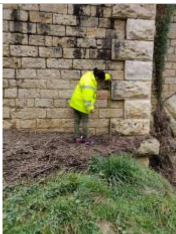
Repère laisse pont SNCF
