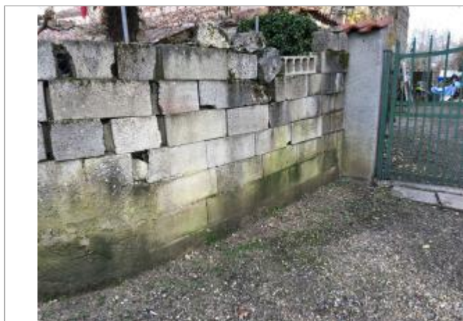
Vue de la laisse de crue
