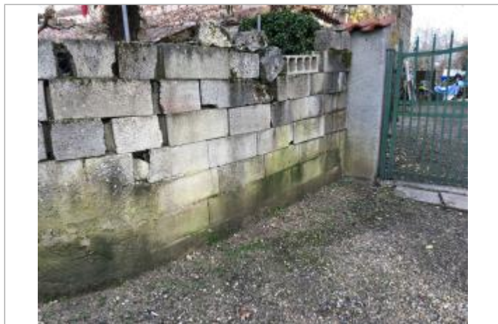
Vue de la laisse de crue
