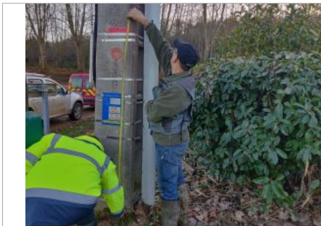
Entrée propriété lieu dit "El Chalet" sur poteau béton EDF
