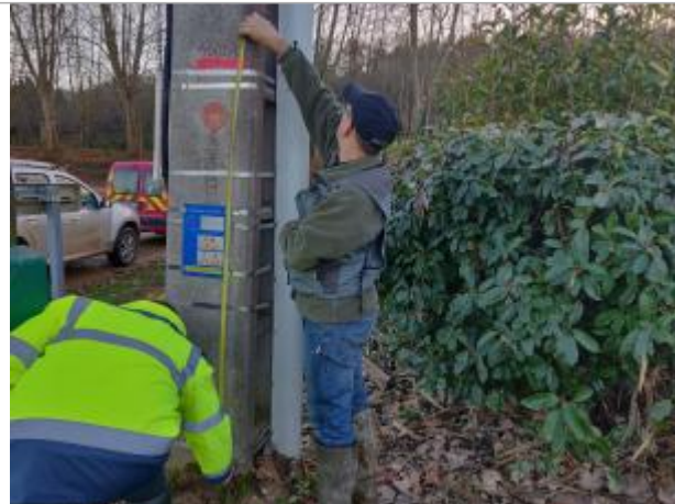
Entrée propriété lieu dit "El Chalet" sur poteau béton EDF
