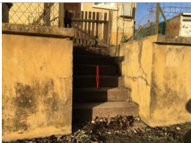
L'eau a atteint le niveau de la deuxième marche soit environ 45 cm au dessus du seuil
