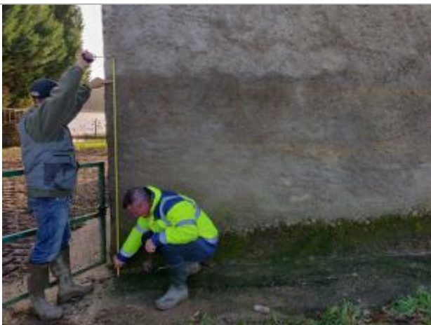
Laisse sur maison à 1,79m de haut par rapport au sol
