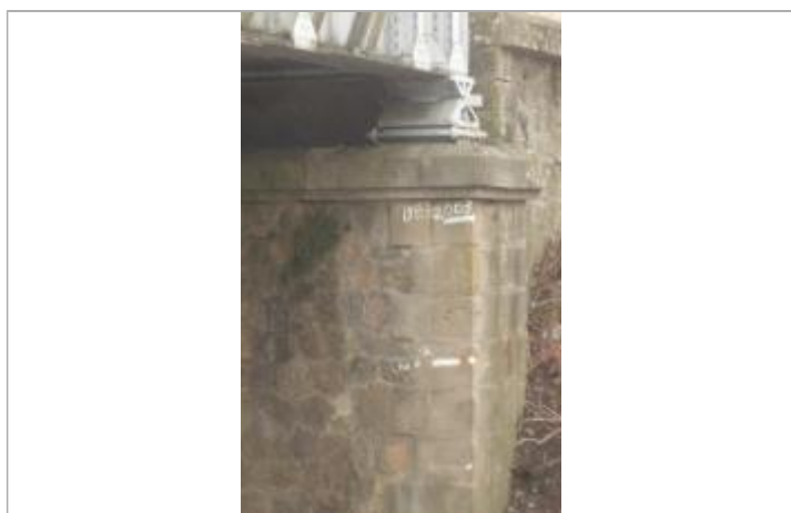
Photo du repère de crue (peinture blanche)
