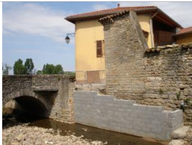
Site sur façade en pierres anciennes (amont du pont et rive droite)
