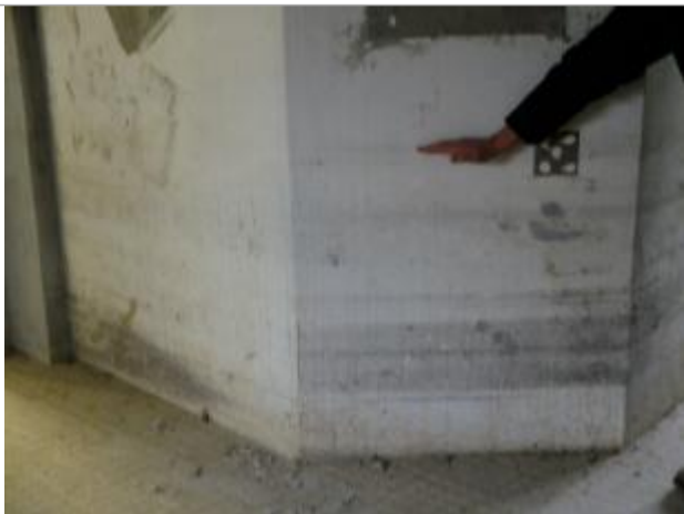
Photo de la laisse de crue (hauteur de la main)
