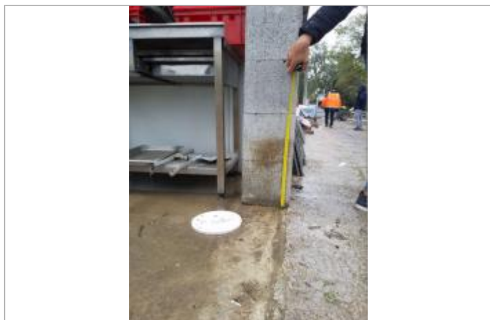
Vue de la PHE - Auteur : Cerema Méditerranée
