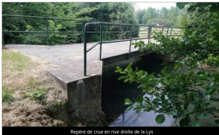
Repère de crue en rive droite de la Lys
