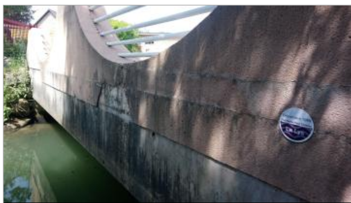
Repère de crue en rive droite de la Lys
