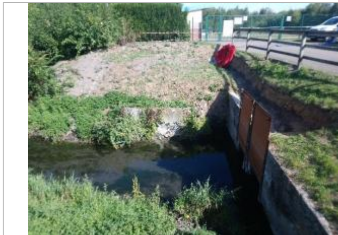
Repère de crue en rive droite de la Loisle
