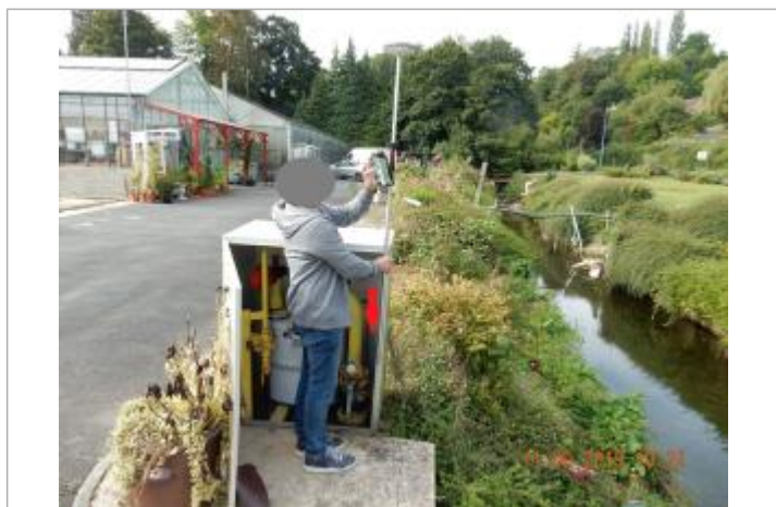
trace d'inondation à l'intérieur d'un caisson
