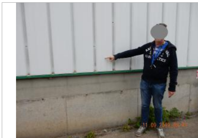
trace sur mur métallique
