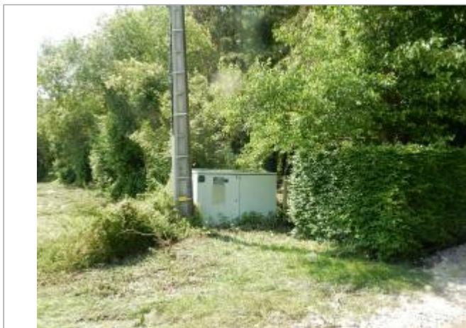
transformateur électrique route de Manerbes
