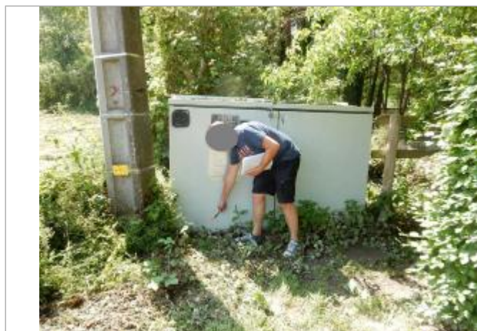
trace peinte sur transformateur
