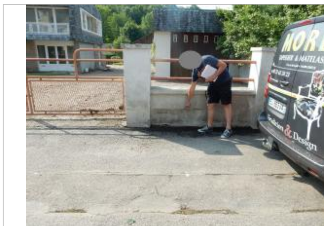
trace sur mur blanc à 37 cm/sol.
