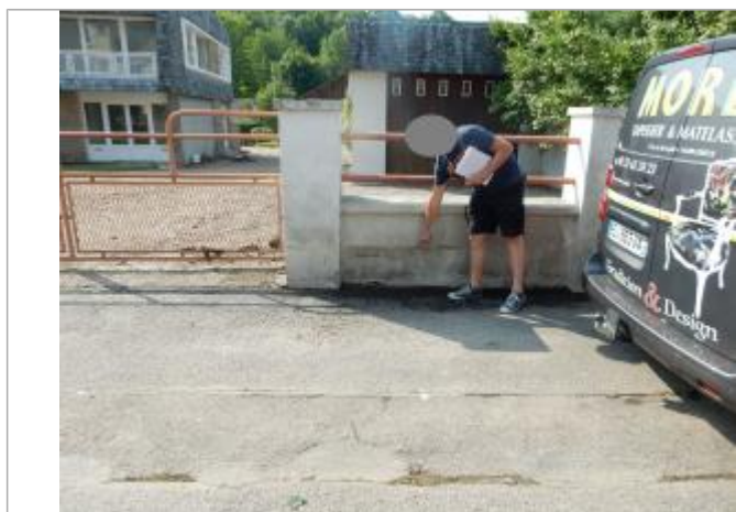
trace sur mur blanc à 37 cm/sol.
