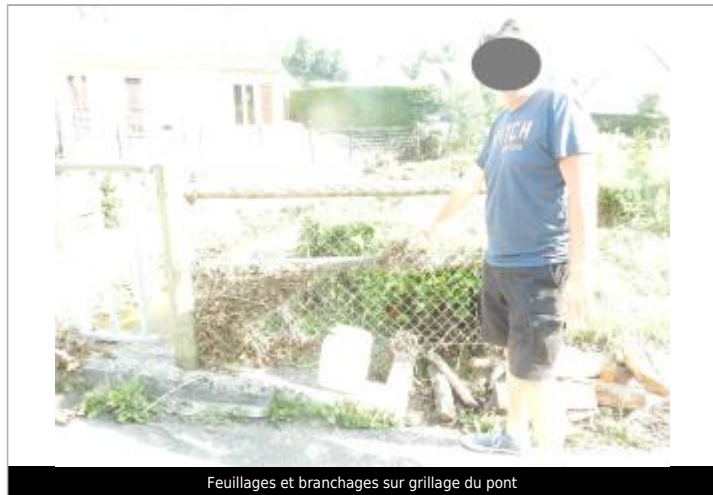
Feuillages et branchages sur grillage du pont
