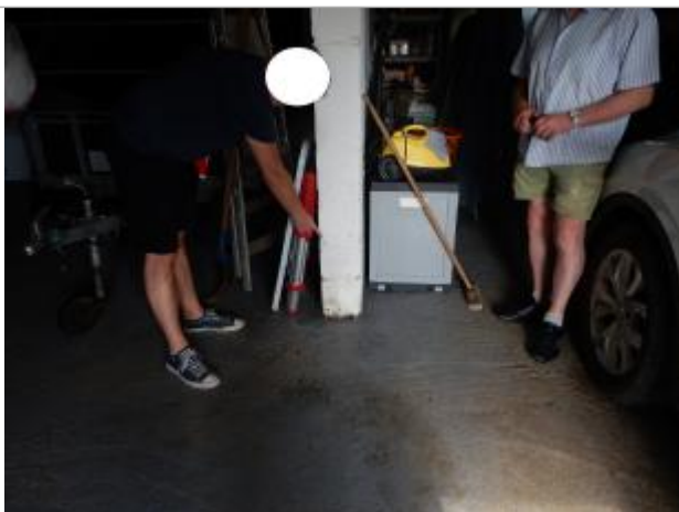
Laisse de crue à 21 cm/sol
