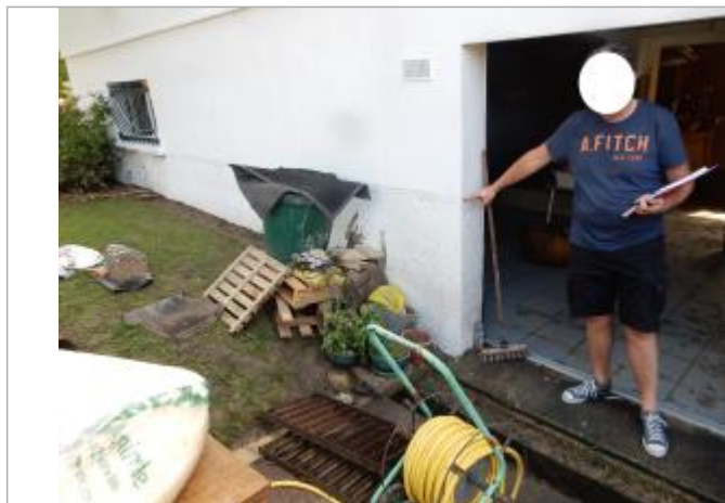
Laisse de crue à 114 cm/sol
