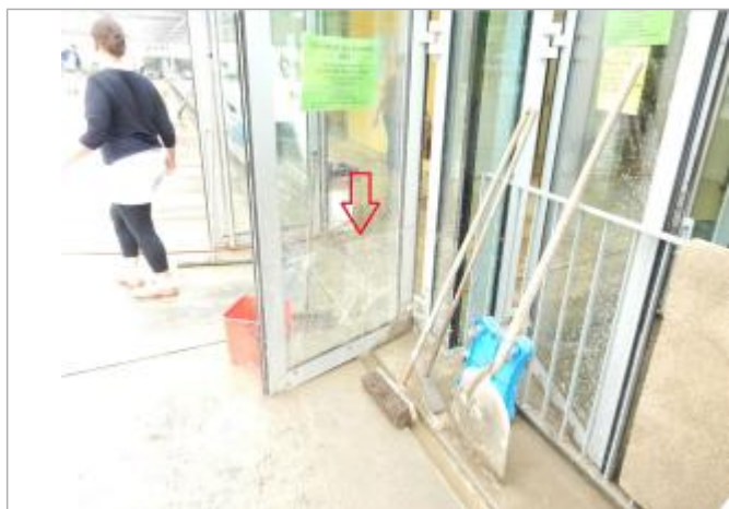
trace sur vitre de la porte à 67 cm/sol.
