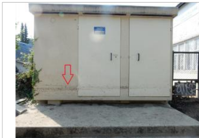
trace sur mur du transformateur
