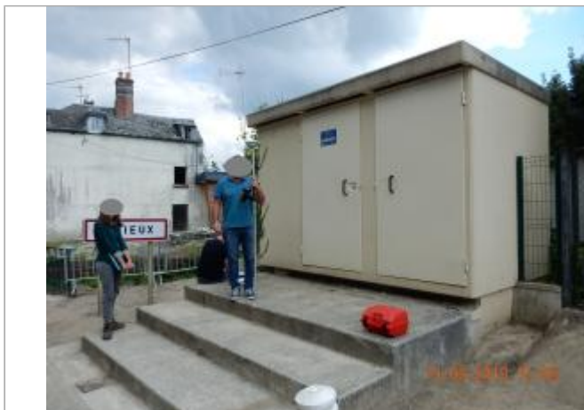
poste transformateur électrique rue henri Papin
