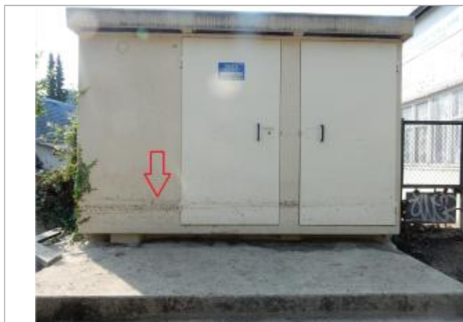
trace sur mur du transformateur
