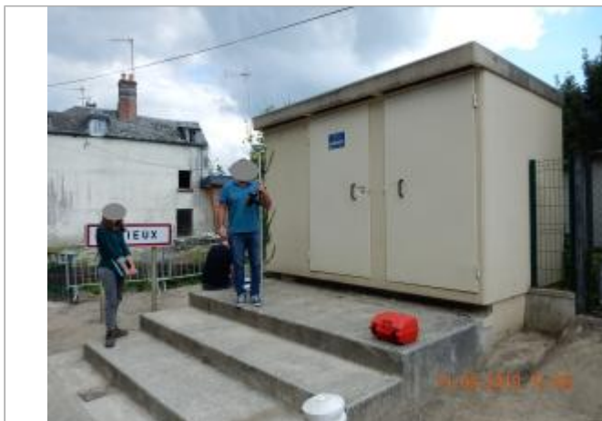
poste transformateur électrique rue henri Papin
