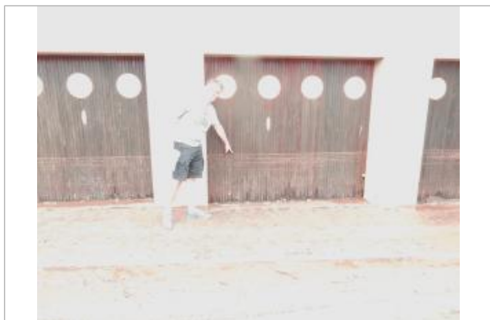
Laisse de crue sur porte de garage à 72 cm/sol.
