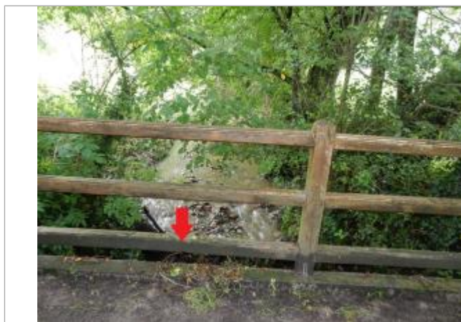
trace sur le haut de la première barre de bois du garde corps 'en partant du bas)
