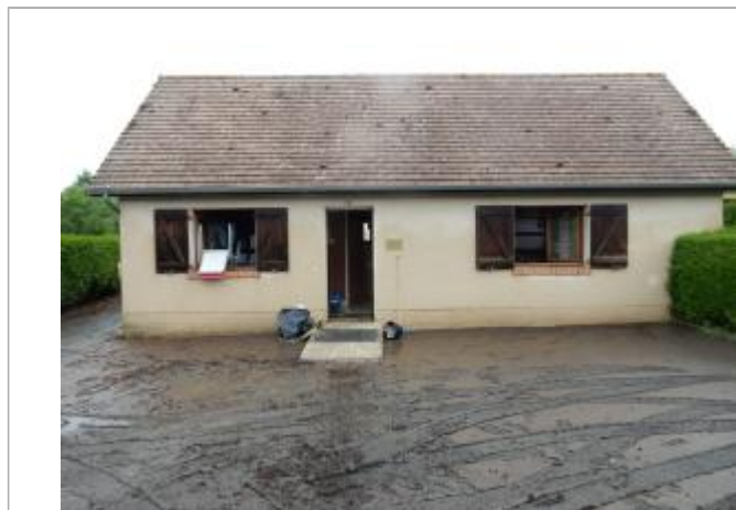
laisse d'inondation sur la façade sud du cabinet médical.
