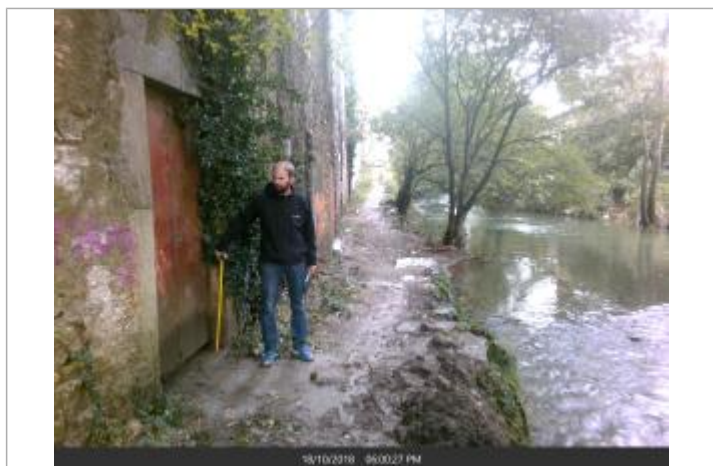
Porte en fer rouillée à coté du cours d'eau
