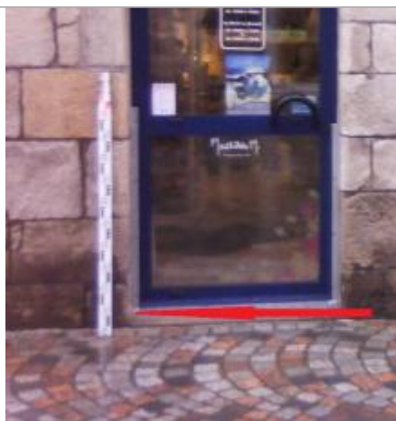
trottoir coté gauche (charnières) de la porte d'entrée du magasin
