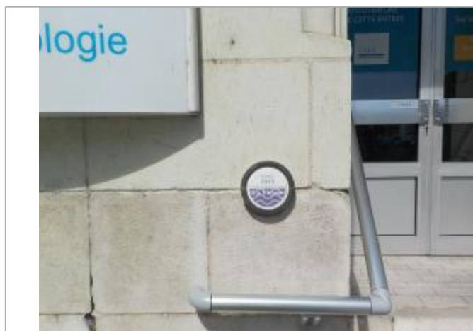
Photos du repère CHAT28-R. Source : 3DI
