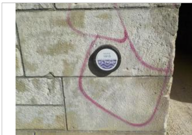
Photos du repère CHAT24-R. Source : 3DI
