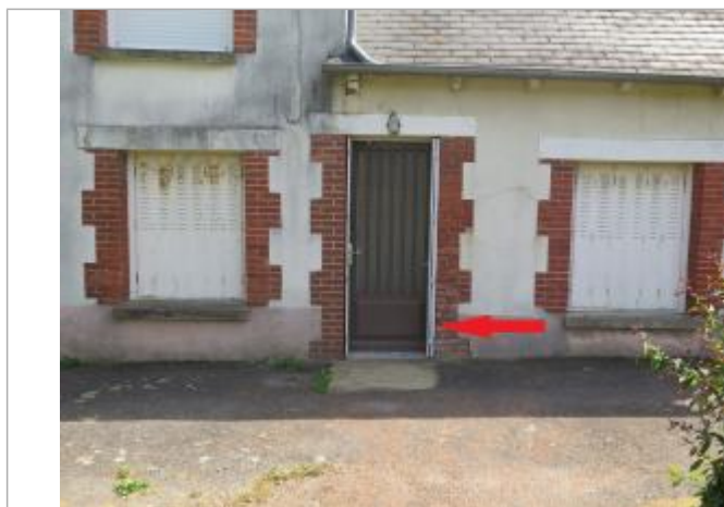
seuil de la porte d'entrée (17/07/2019)
