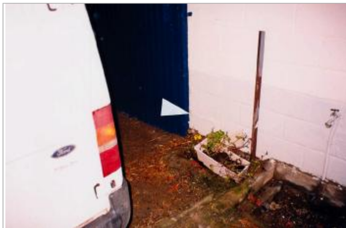
Laisse de crue devant le hangar ( 19/01/2001)
