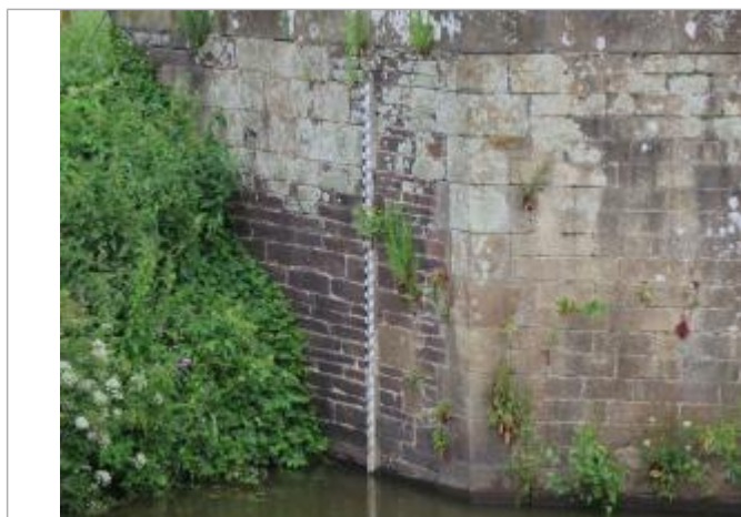
Echelle limnimétrique à l'aval de l'écluse de Cicé à Bruz
