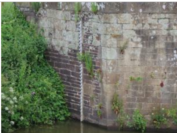
Echelle limnimétrique à l'aval de l'écluse de Cicé à Bruz
