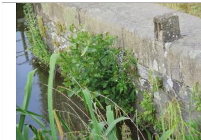
Echelle limnimétrique à l'amont de l'écluse du Comte à Rennes
