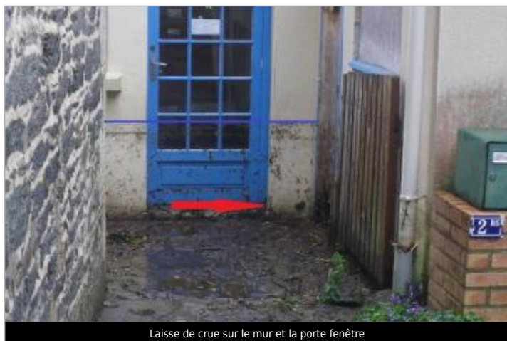
Laisse de crue sur le mur et la porte fenêtre
