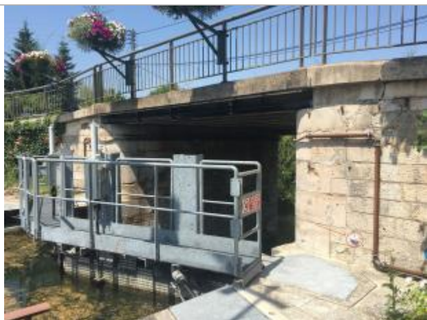
Repère de crue VNF sur la pile de pont à l'aval rive droite de l'écluse
