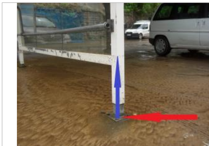
laisse de crue au niveau de l'abri
