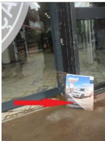
Laisse de crue sur les vitrines à l'entrée du sipermarché
